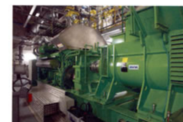
ガスエンジン
