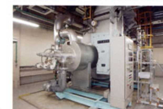
ガス焼きボイラ
