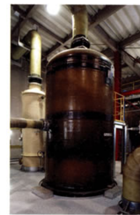
アルカリ洗浄塔
