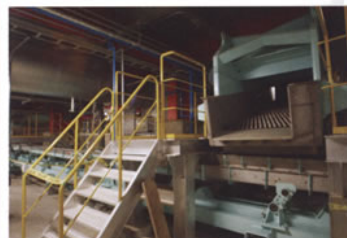
スラグメタル設備
